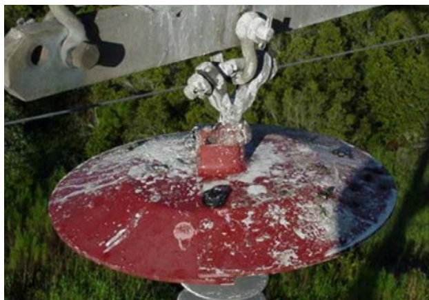
Рис. 1. Загрязнения биологическими отходами изоляторов
