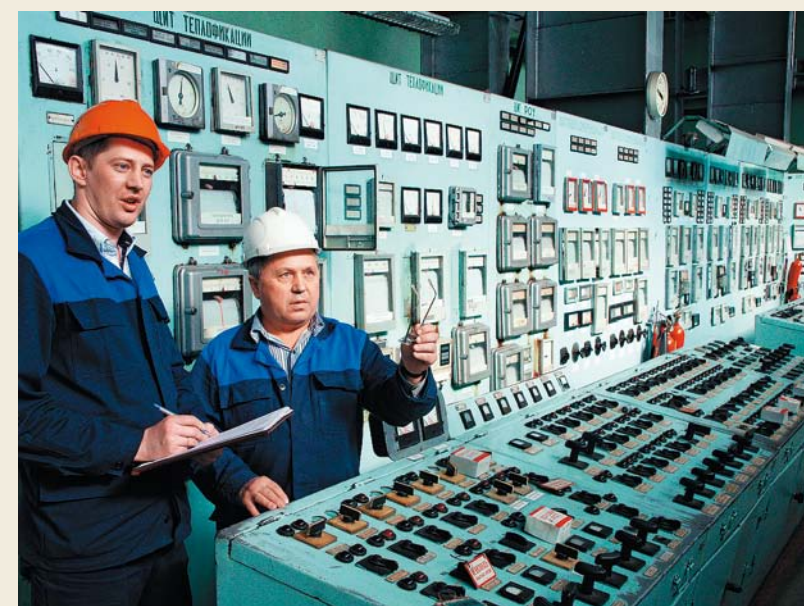
Центральный тепловой щит управления котлами. Ведение режима работы котлов. Начальник смены котельного цеха Юрий Владимирович Молчанов и машинист Юрий Петрович Андреев
